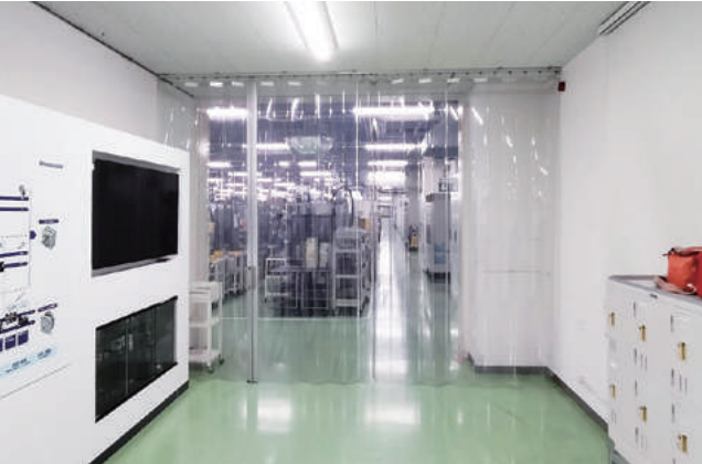
空調使用電力削減のため、ビニールカーテンを設置
