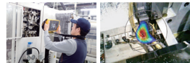
超音波カメラによるエア漏れ状況の確認 エア漏れの様子（超音波カメラ画像）
